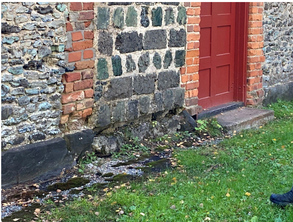
Figur 30. De urfallna slaggstenarna i sockeln mot öster. Ska åtgärdas när vädret tillåter. Foto: 2022-10-04.
