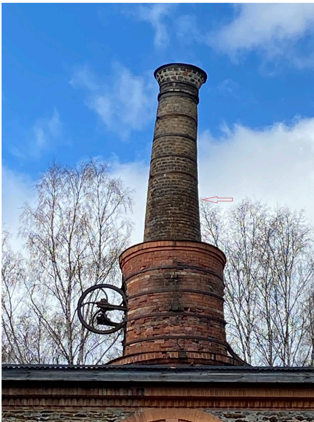
Figur 17. Den övre skorstenen plockades ner till nivån för pilen där lutningen i stort eskalerade. Foto: 2021-04-30.
