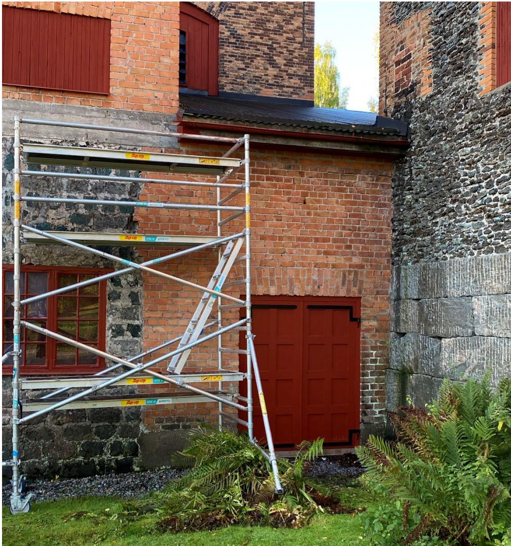
Figur 29. Hörnet på den norra fasaden mot rostugnen. Virket i takfoten var murket och genom detta har också hängrännan en felaktig lutning. Alla delar ska bytas ut och målas. En ny hängränna med utkast mot öster, ska återmonteras. Foto: 2022-10-04.
