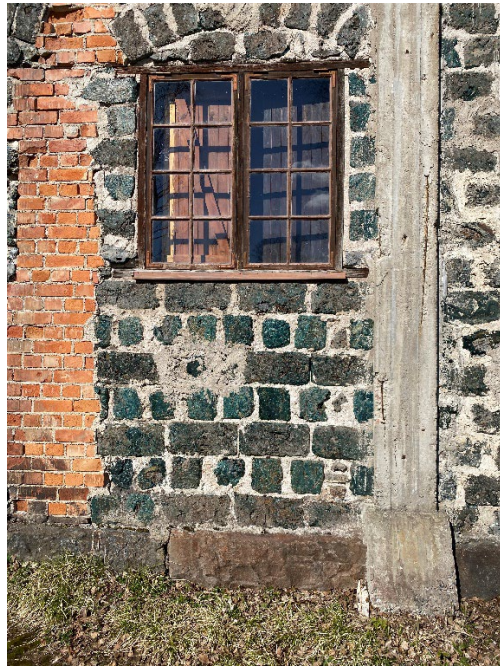
Figur 5. Exempel på fönsterbåge i behov av underhåll på den östra fasaden. Notera också skador i gjuten pilaster. Foto: 2021-04-30.
