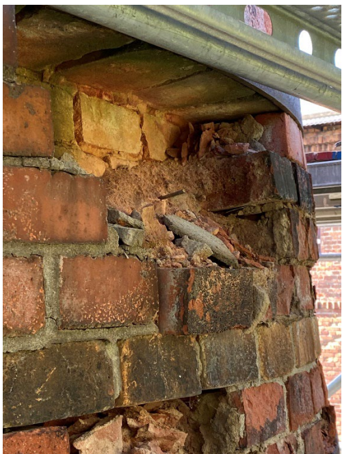
Figur 10. Tegeltvättning och vittrade fogar i den nedre delen av skorstenen. Foto: 2021-06-10.
