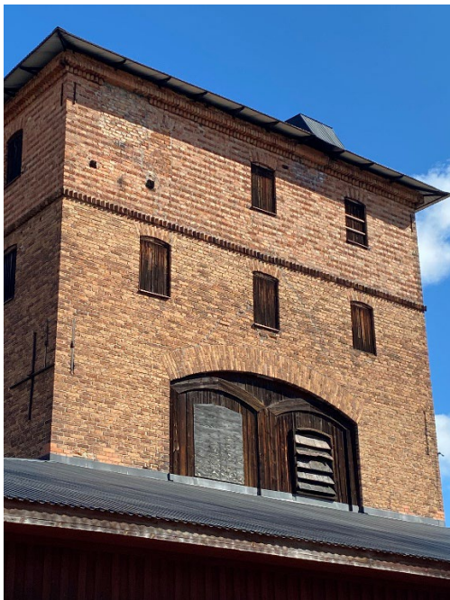
Figur 6. Masugnens södra sida. Alla luckor i trä var i stort behov av målning, liksom jalusier av järn. Foto: 2021-04-30.
