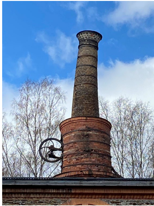
Figur 9. Den övre delen av rostugnens skorsten lutade kraftigt. Foto: 2021-04-30.
